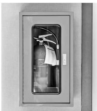
รูปที่ 3 ชุดอุปกรณ์ดับเพลิง
