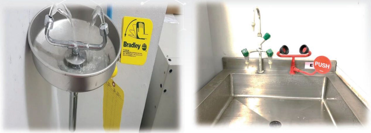
รูปที่ 13 ตัวอย่างก๊อกน้ำสำหรับล้างตา (emergency eyewash)
